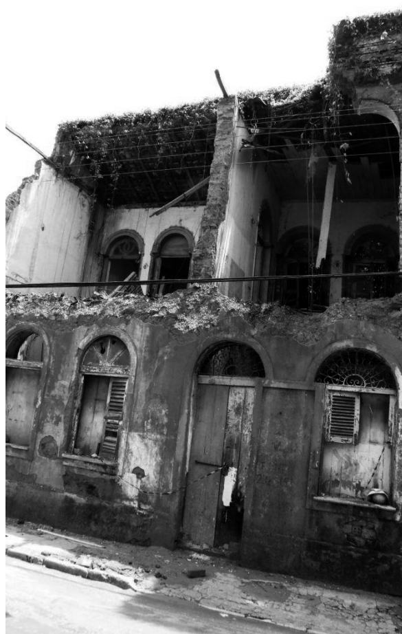
Figura 4. Casarão em ruína
